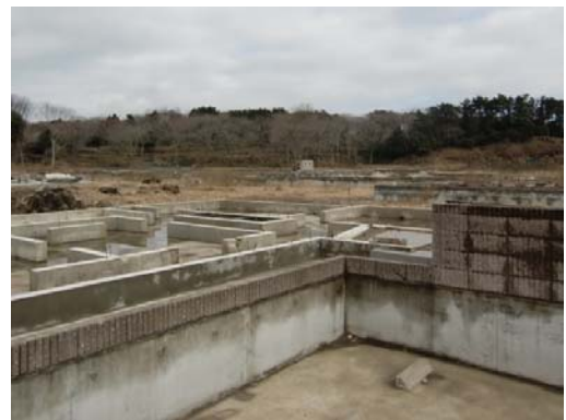
基礎部分だけ残った住宅跡地
